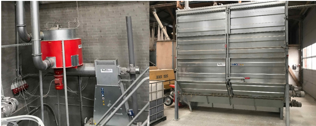
Figur 6. Utrustning för helautomatisk strömedelstillförsel från BoPil A/S. Utrustningen är placerad i en egen brandavskiljd byggnad tillsammans med bland annat foderfickor. Foto RISE Jordbruk och trädgård.
